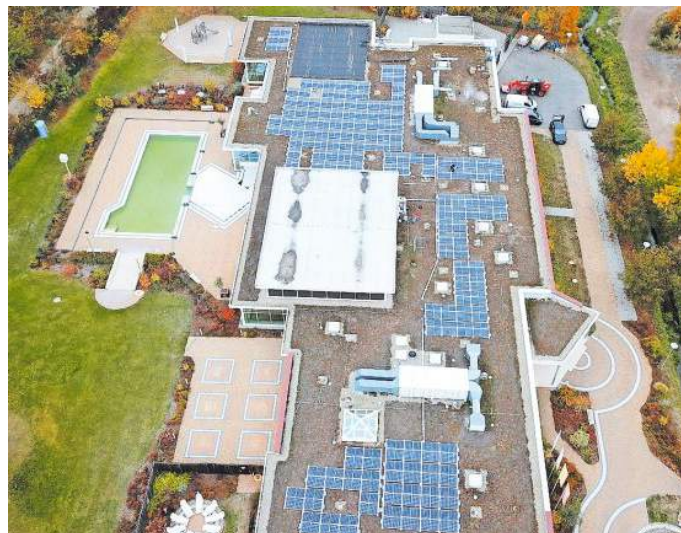
Blick von oben: Eine besondere Herausforderung waren die vielen Aufbauten des Schwimmbades, an die die PV-Anlage angepasst werden musste. Als Balastierung der Anlage zum Schutz gegen den Wind wurde u.a. die ohnehin auf dem Dach vorhandene Kiesschüttung verwendet.
