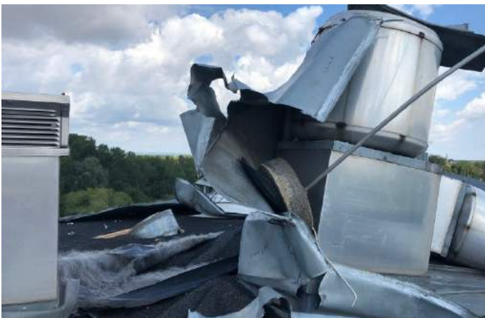
Zerstörung der Lüftungsaufbauten samt Einhausung
