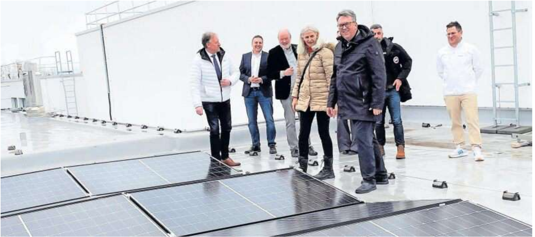
Auf dem Kreisbad Aquabella ist nun bereits die zweite Anlage in Betrieb.
